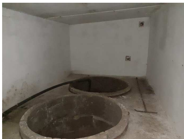
Obr. č.5 velkoobjemové studně ve zděném objektu
